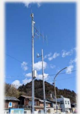
防災行政無線設備(津和地漁港)
